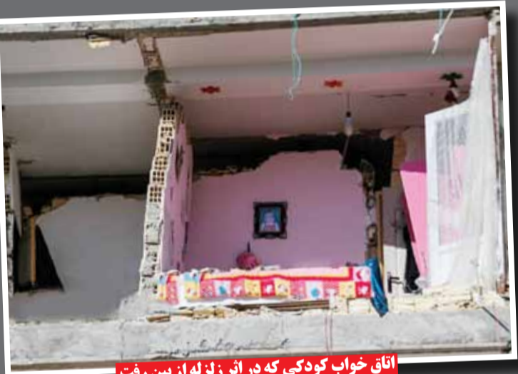
اتاق خواب کودکی که در اثر زلزله از بین رفت
